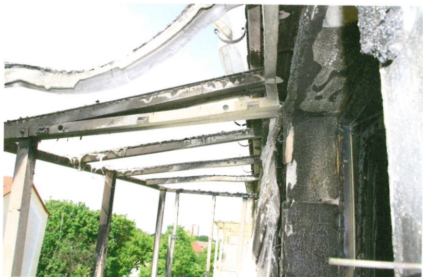
2 Durch einen Wohnzimmerbrand beschädigtes WDVS.
