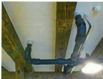
2 Regelgerechte Abschottungen in einer Trockenbaukonstruktion.
