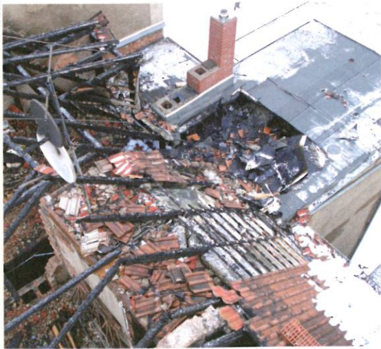
1 Auf die Qualität der einzelnen Maßnahmen kommt es im Brandfall an.
