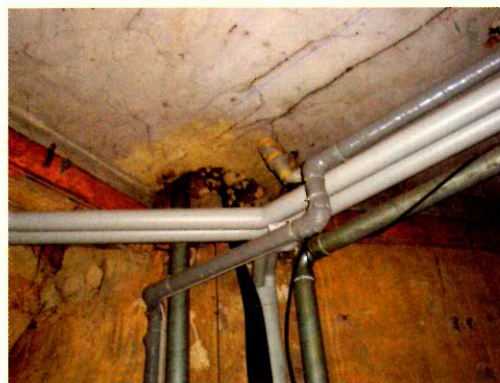
4 Probleme bereiten oft nachträgliche Installationen.
