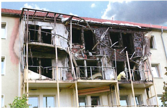
Abb. 2: Brandbeschädigtes WDV (Foto: Feuerwehr Erfurt)
