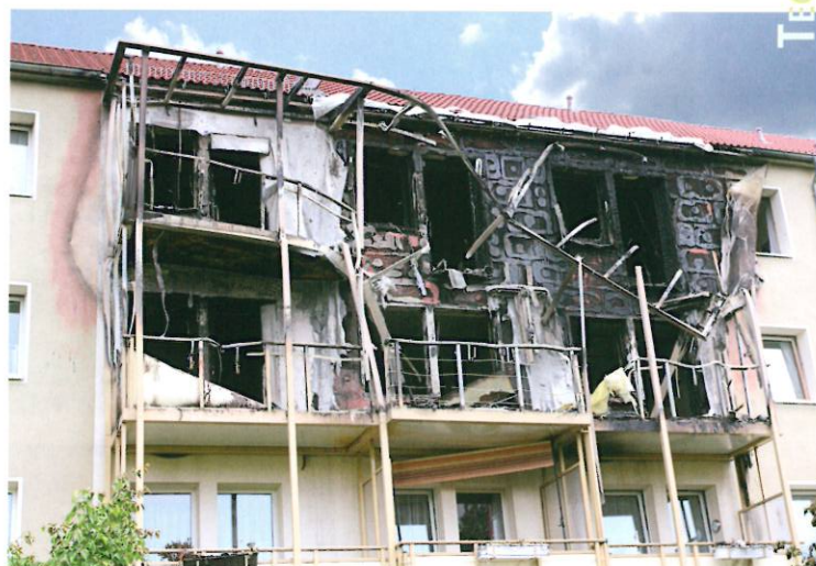
Abb. 2: Brandbeschädigtes WDV (Foto: Feuerwehr Erfurt)
