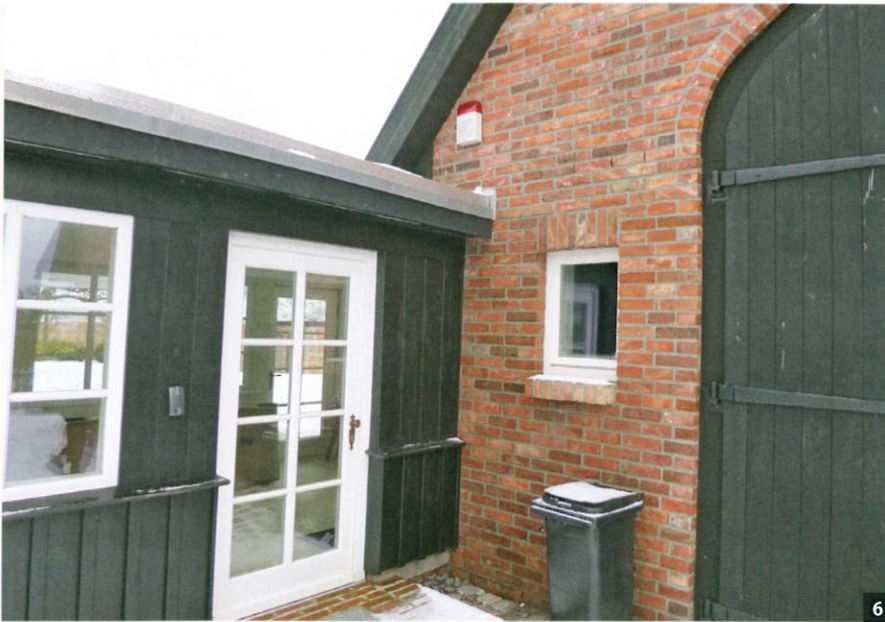
Abb. 6: Durch ein reaktives Brandschutzsystem wurde diese Holzschalung zu einem schwer entflammaren Bauteil.
