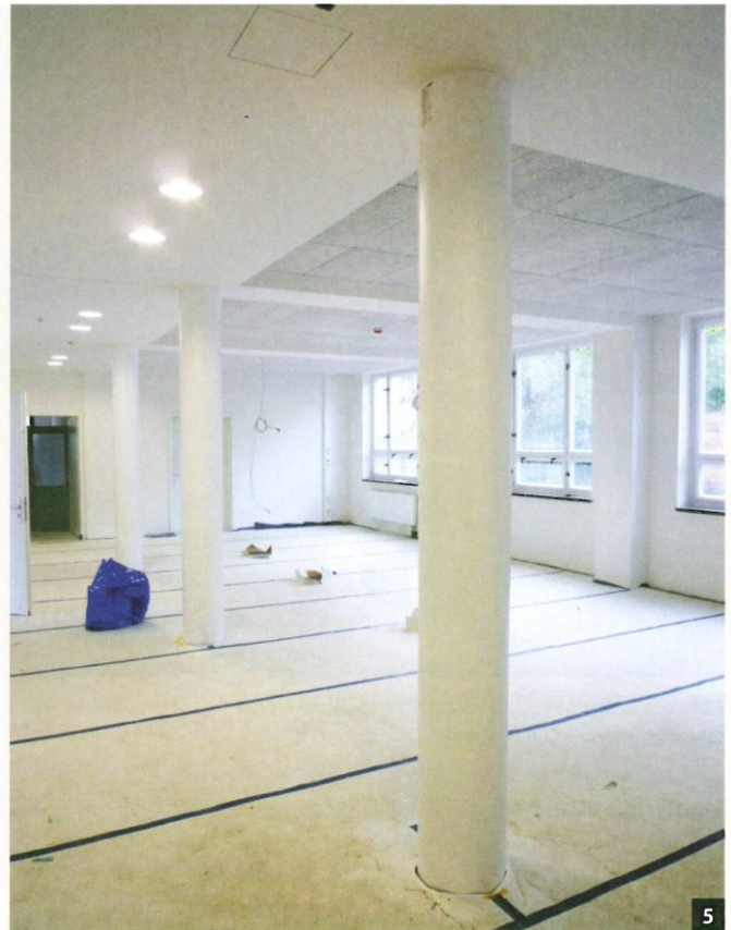
Abb. 5: Wird eine Stahlstütze nachgerüstet, dann muss sie, wie hier oben links auf der vorderen Stütze, gekennzeichnet werden.
