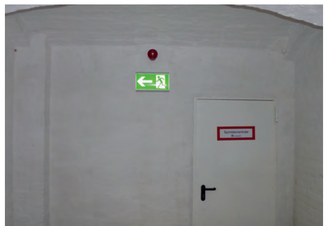
Abb. 7: Notwendige Brandschutzmaßnahmen wegen einer Nutzungsänderung: Löschanlage, Brandmelde- und Alarmierungsanlage, Rettungswegkennzeichnung
