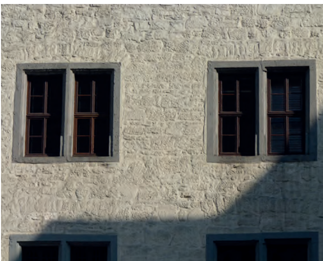
Abb. 5: Die Anleitermöglichkeit war wegen der abweichenden Situation in der Örtlichkeit zu überprüfen. Diese Wand war ein besonders kniffliger Einzelfall: Hier wurde mit der Brandschutzdienststelle abgestimmt, dass man bei entsprechender Gefahrensituation die wertvollen steinernen Gewände notfalls zerstören darf, um gegebenenfalls anleitern zu können.
