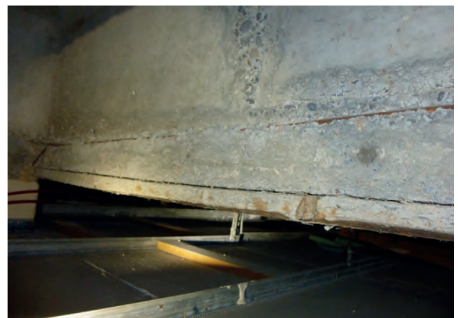
Abb. 3: Ein mangelhafter Feuerwiderstand der denkmalgeschützten Konstruktion zieht keine konkrete Gefahr nach sich.
