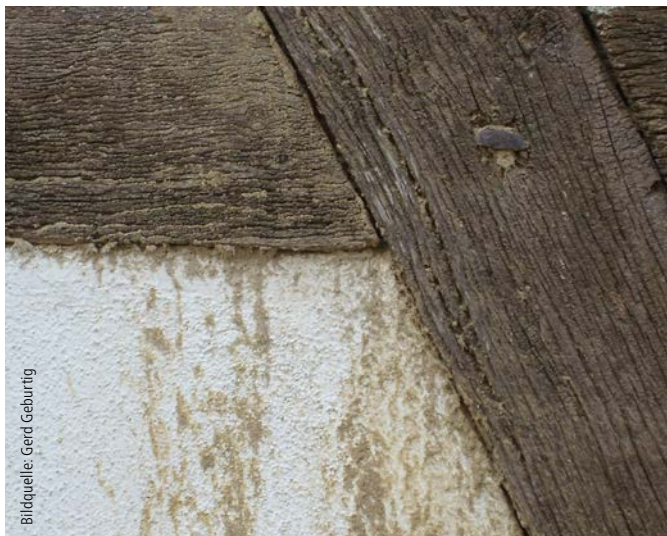
Bild 4: Frühzeitig nach einer Sanierung festgestellter Mangel: Weil die Anschlüsse vom Gefach zum Holz nicht sorgfältig ausgeführt wurden, wäscht sich die Gefachfüllung aus Lehm aus.
