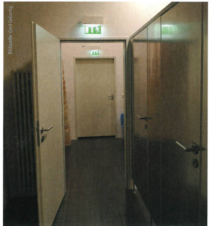
Abb. 2: Überflüssige „doppelte“ Rettungswegausweisung aus einem Toilettenbereich.
