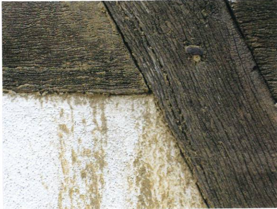
Abb. 4: Frühzeitig nach einer Sanierung festgestellter Mangel
