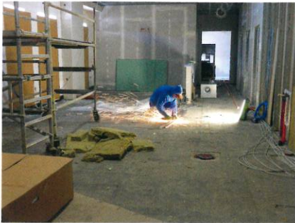
Abb. 12: Besonders gefährliche Arbeiten bei einer Sanierung können zu Schäden führen
