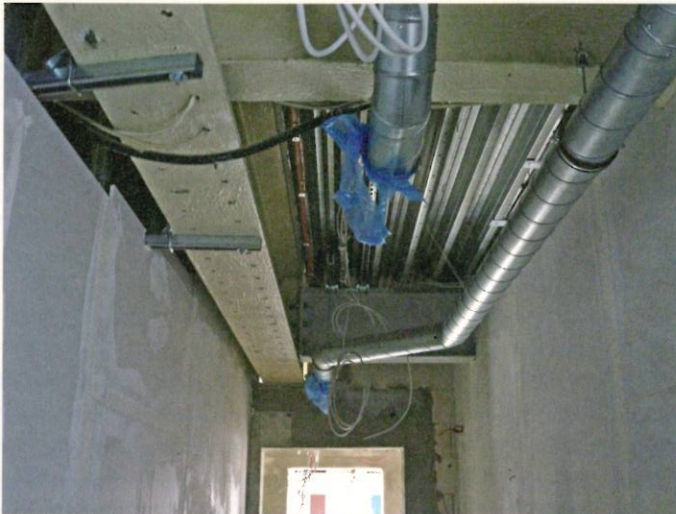
4 Die falsch angeschlossene Trockenbauwand musste zurückgebaut werden.
