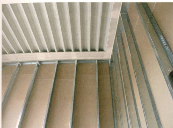
5 Diese Konstruktion war nicht durch das abP gedeckt. Dennoch »rettete« eine nachträgliche und schutzzielorientierte Abweichung hier die Einbausituation.
