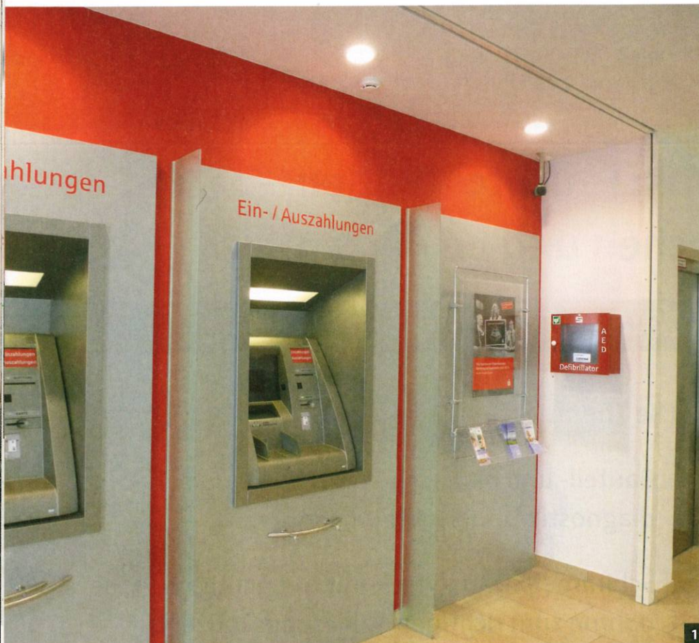
Abb. 1: In dieser Bank wurde ein Rettungsweg mit einer temporär schließenden Rauchschutzschürze nachgerüstet. Sie ist auf dem Bild an der Schiene zu erkennen.
